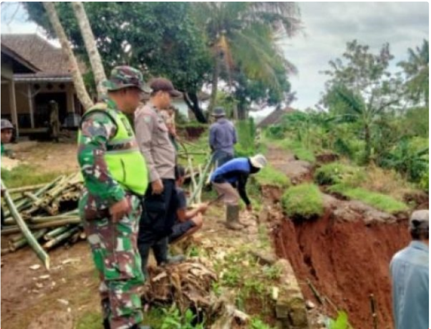
Monitoring dan Perbaikan Jalan Akibat Bencana Alam di Desa Tamanjaya, Kapolsek Ciemas: Antisipasi Bencana Lebih Besar
